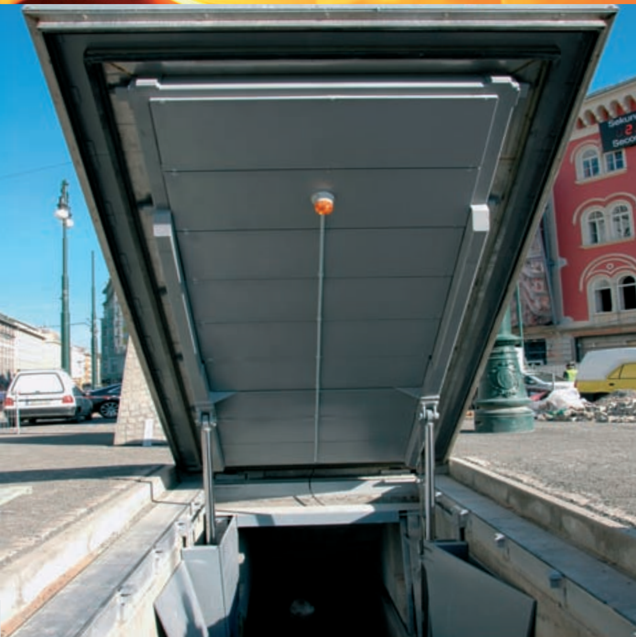
Únikový poklop 2500 x 5000 mm pro únik osob při požáru, pojezdňý osazený do komunikace Náměstí Republiky Praha, jako vyústění únikové podzemní chodby ze třípodlažních podzemních garáží. Otevírá se automaticky.
