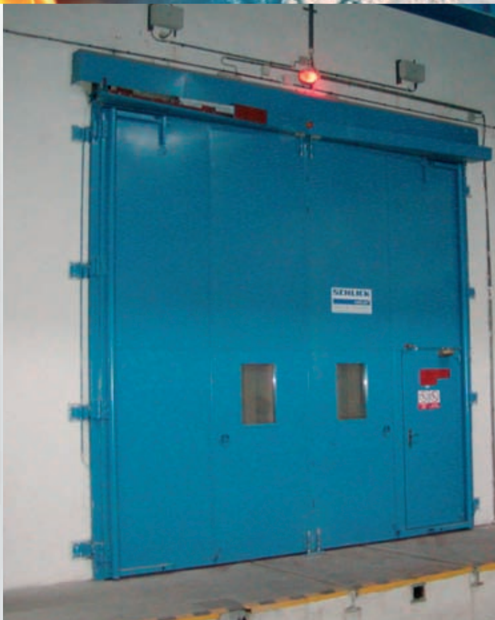
Tryskací tunel SIEMENS - Kolejová vozidla Praha
